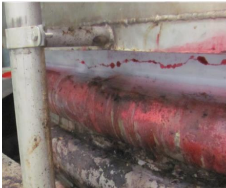
ترک در دیواره لوله (با قالب قرمز قابل مشاهده است)
